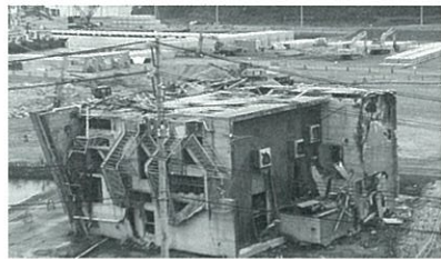
基礎から真横に倒れているビル
